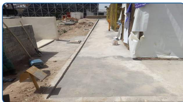
محوه‌سازی اطراف ایستگاه گاز به منظور پیشگیری از حریق
